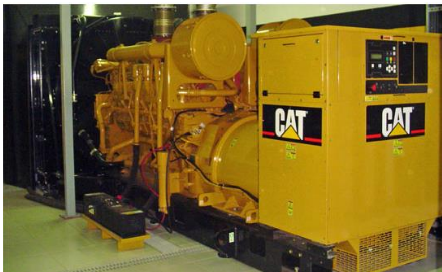
Figura 8 - Geradores Fonte: Clementino (2001).
