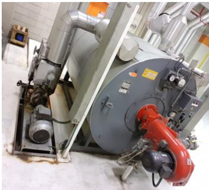
Figura 17 - Caldeira de aquecimento fluído térmico Fonte: VM (2018).
